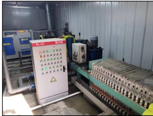
污水处理设备间
